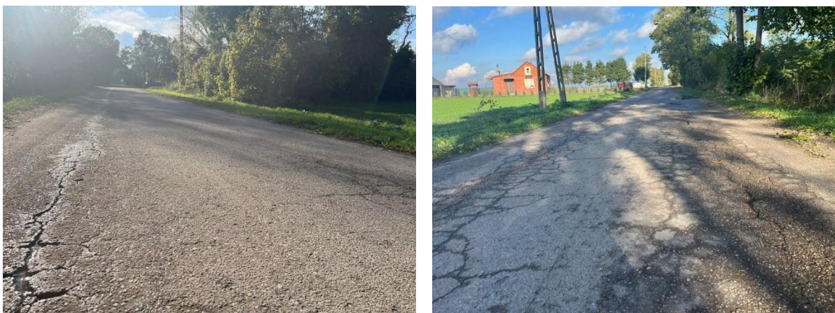
Rysunek 1. Stan techniczny drogi przebiegającej przez Sosenkowo
